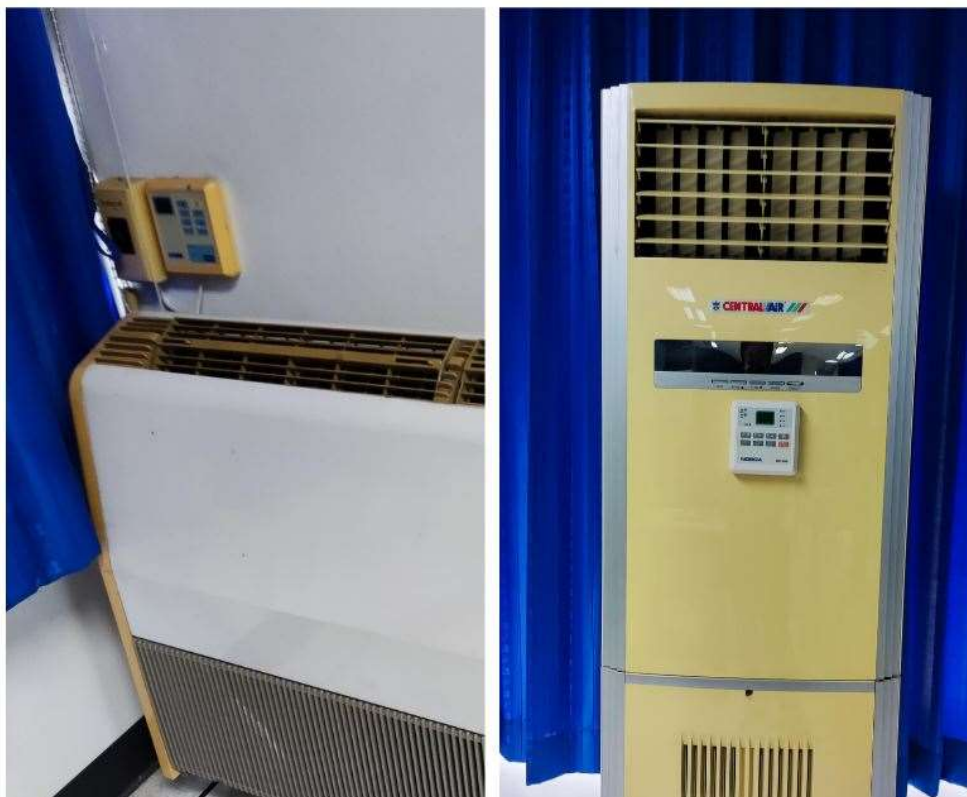
ภาพที่ 4.1.3 ภาพประกอบเครื่องปรับอากาศ
