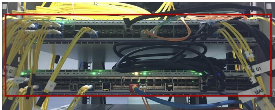
รูปที่ 4.18 Core Switch Alcatel 6900-X72 ฝั่งสำนักดิจิทัลฯ 2 ตัว ใช้สาย Fiber optic ต่อ Stack ทำให้เสมือนรวมเป็นตัวเดียวกัน
